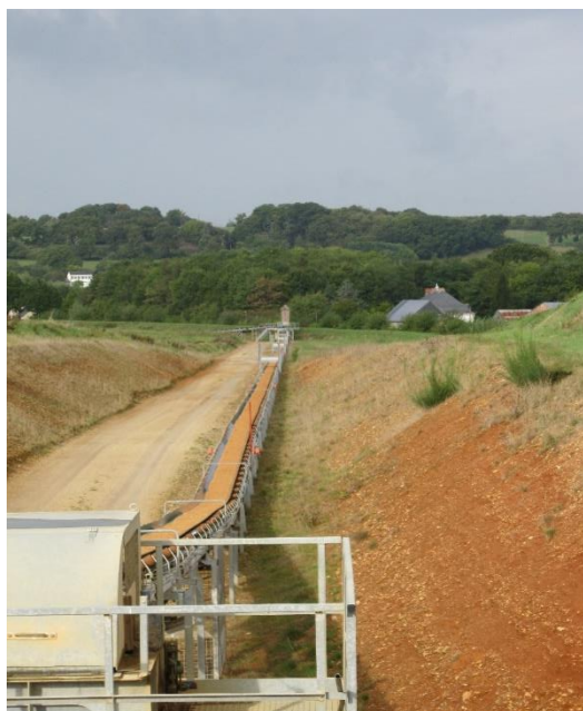
Exemple de tapis de plaine qui sera utilisé sur le site de la Guignière
